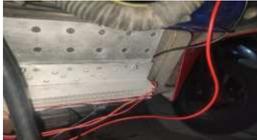
Gambar 5. Sistem Pending Tambahan Yang Terpasang
